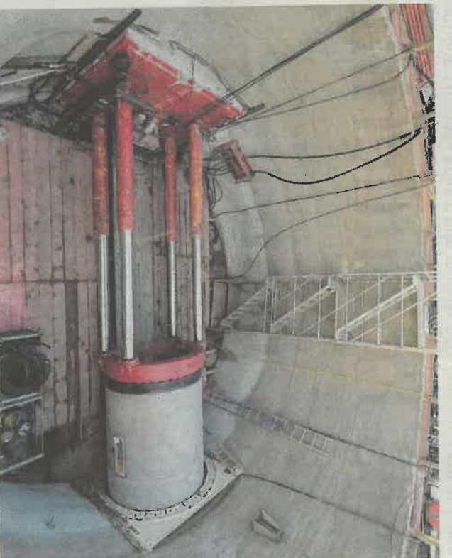
Von einem Grundstück an der Speyerer Straße aus wird derzeit ein Abwasserkanal mit zwei Metern Durchmesser in Richtung Bahnstadt gebaut.
