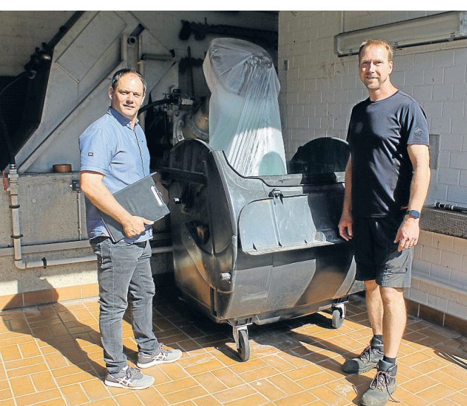
Jens Lambertus (links) und Frank Getzin stehen im Rechengebäude vor dem Container mit dem Rechengut.
