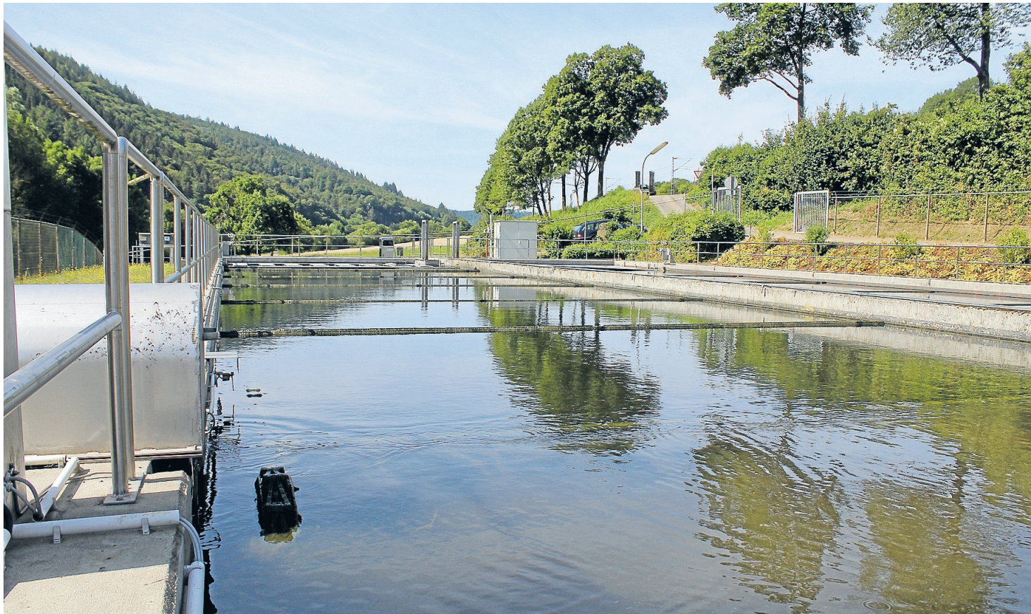
Das Nachklärbecken erstreckt sich über eine weite Fläche, damit der Schlamm sich am Boden in Ruhe absetzen kann. Anschließend fließt das gereinigte Wasser zurück in den Neckar. Fotos: Moritz Bayer
